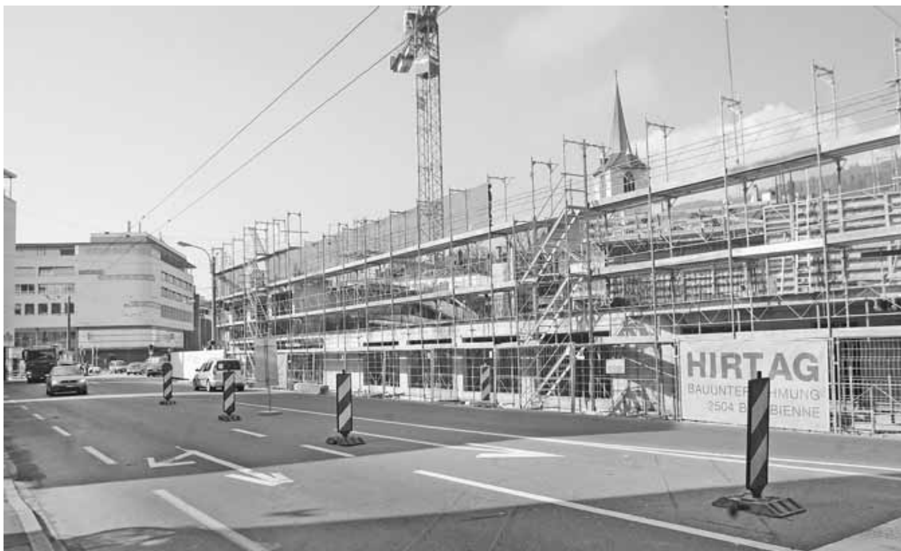
Die Baustelle steht dazwischen: Der Blick von der Freiestrasse auf die Bieler Altstadt gehört der Vergangenheit an.
